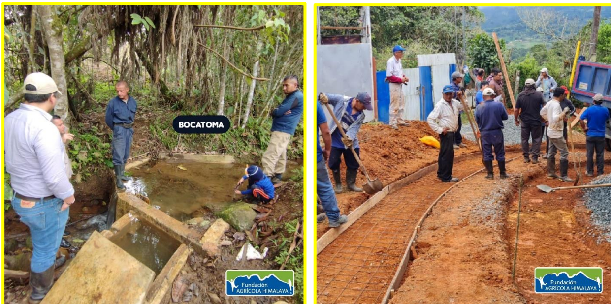
Figura 11. Acueductos y cinta huellas veredales
